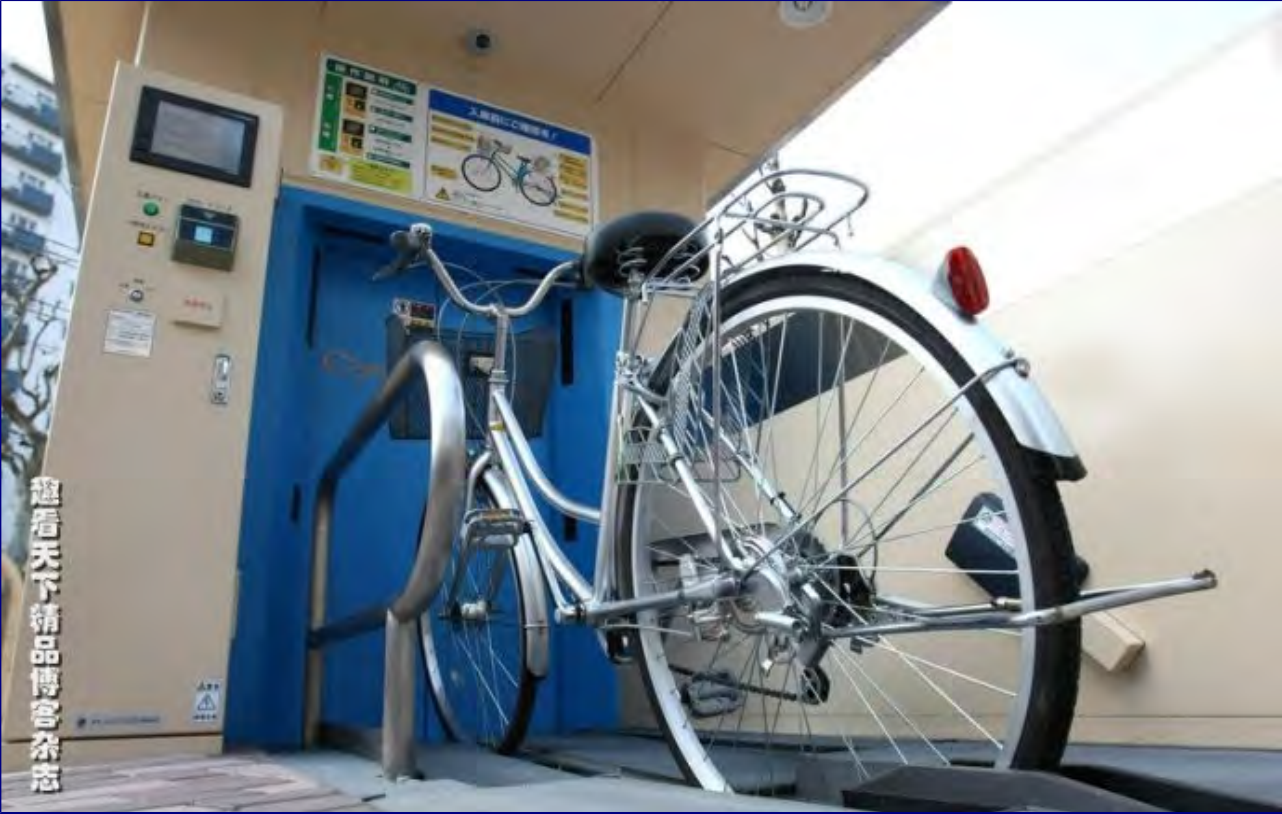
日本东京，一辆自行车进行全自动地下停车场的电梯。
