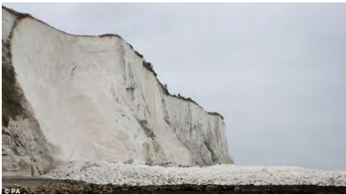
坍塌后裸露出来的新岩层犹如被巨斧削割过一般
