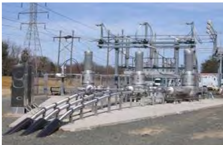
美国纽约长岛电力局电缆节点
